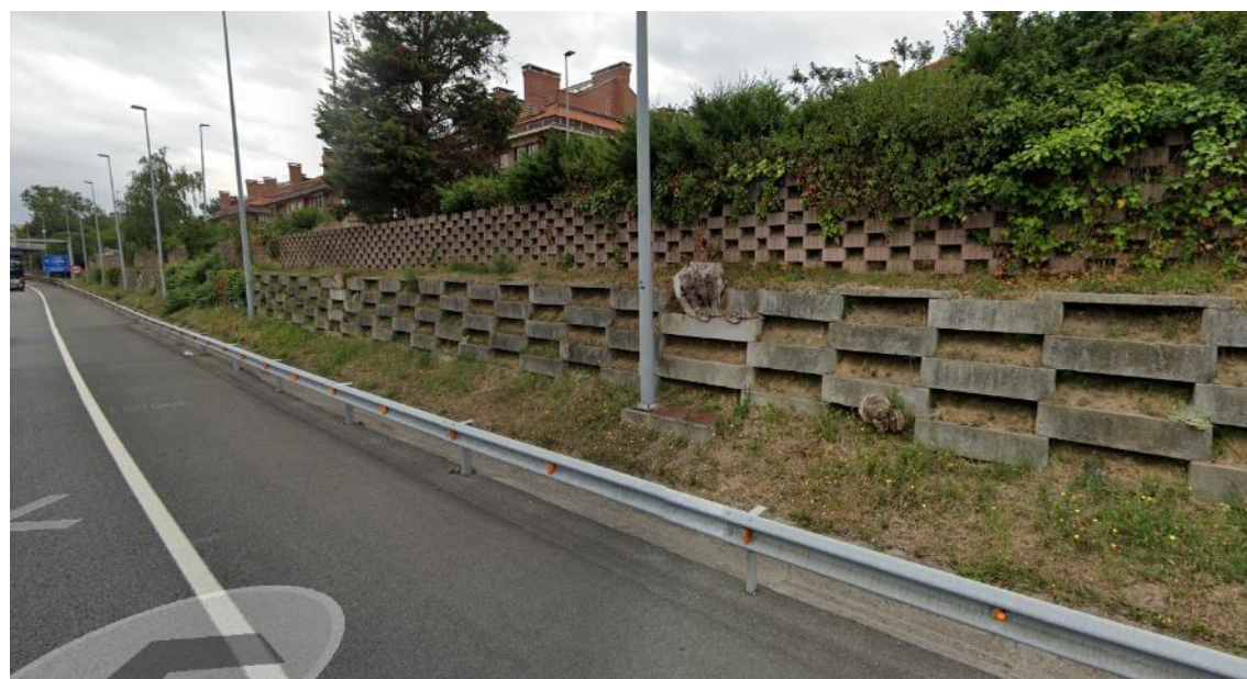
Figura 50: Muro jardinera afectado en fase de obra
